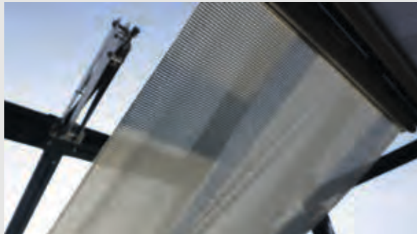
Befestigung, trotz Fensteröffner
